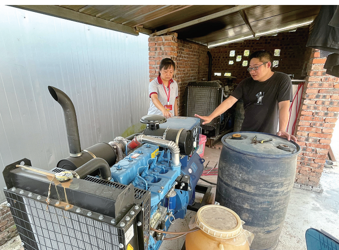
8月19日,荣昌区政协委员曾味到养殖户家中调研设备电源等应急设施及供水供电情况。胡文丽摄
